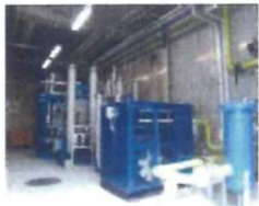
ガス精製・圧縮
